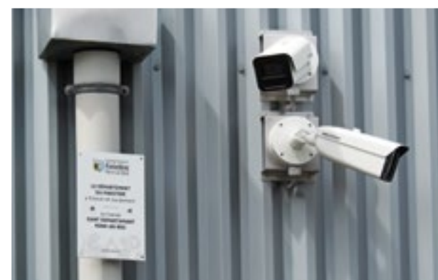
INSTALLATION DE NOUVELLES CAMÉRAS DE VIDÉOSURVEILLANCE
