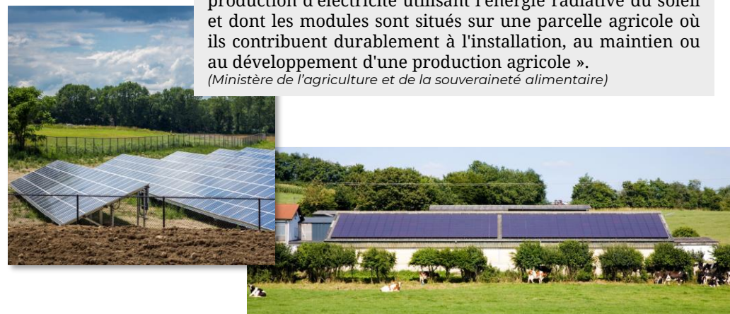
Développement du photovoltaïque en Bretagne (Chambre d'agriculture de Bretagne)
