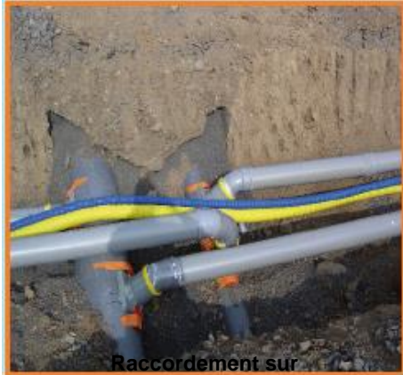
Raccordement sur collecteurs séparatifs
